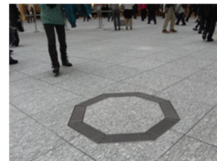
地中熱利用冷暖房の吹き出し口
