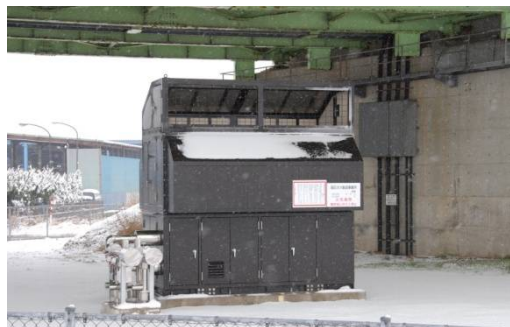
他ICの空気熱源ヒートポンプ(高山IC)
