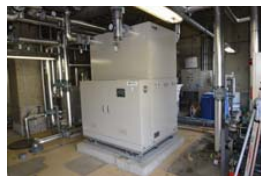
地中熱ヒートポンプ
