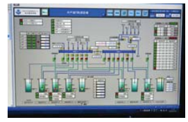
中央監視室の監視画面
