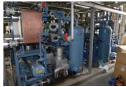
地中熱ヒートポンプ(計4台)
