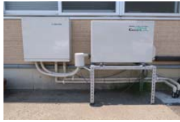
地中熱ヒートポンプ
