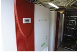
ヒートポンプ(130kW×3台)
