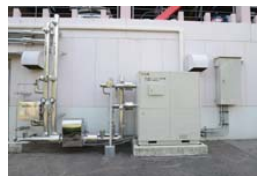
地中熱ヒートポンプ
