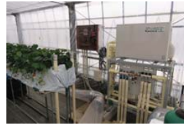
地中熱ヒートポンプシステム
