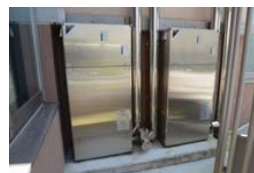
地中熱ヒートポンプ(10kW×2台)
