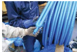
熱交換パイプ(Uチューブ)
