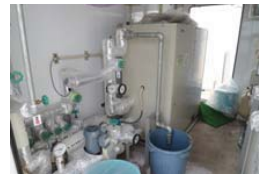
地中熱ヒートポンプ(33.5kW)
