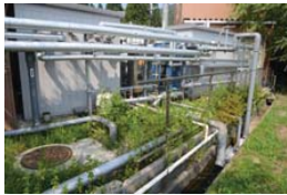
原水施設(揚水井、フィルター)
