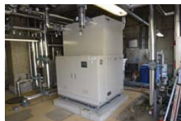
地中熱ヒートポンプ
