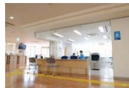
地中熱空調エリア(事務室)
